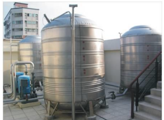
說明：設置於屋頂之中水及雨水回收水箱
