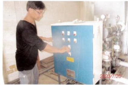
電控檢查中作業
