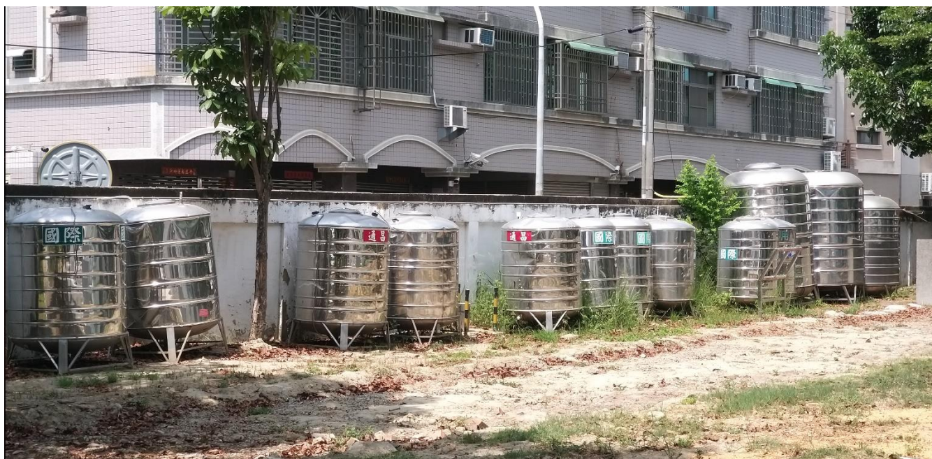
◆安順國小水資源再利用水塔
