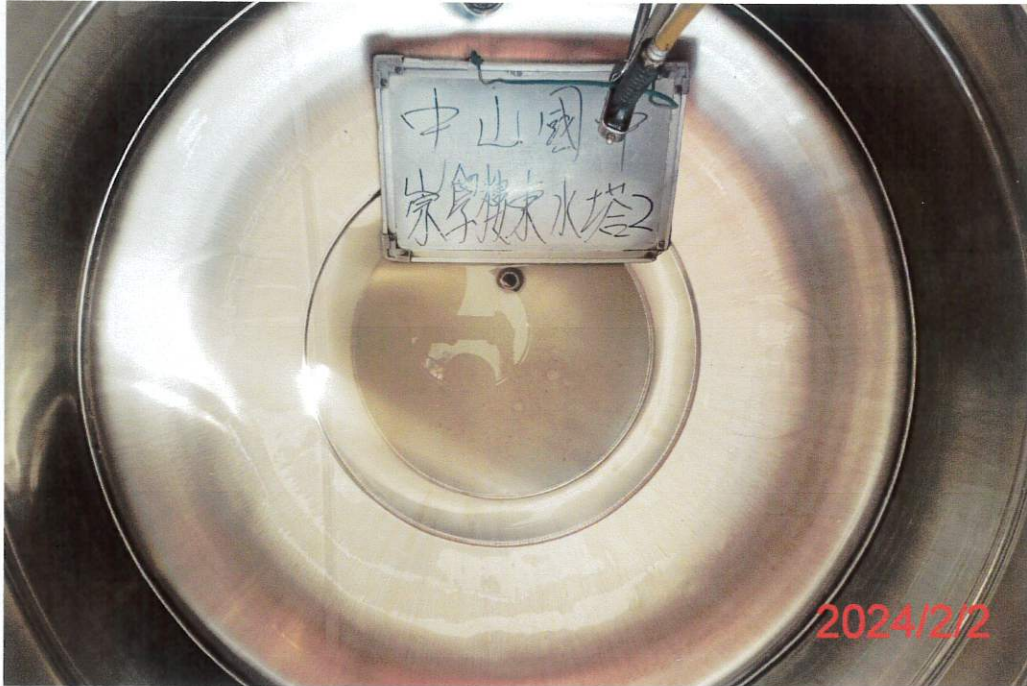
(崇學樓東側-2)水塔清洗前
