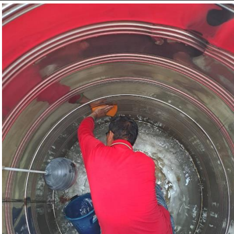
宿舍水塔定期清洗
