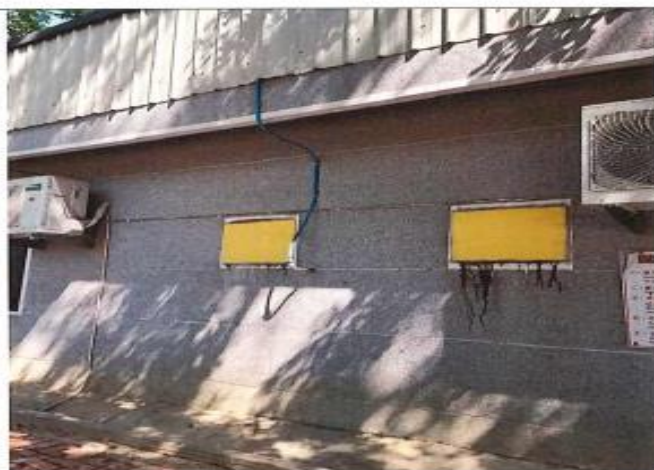
教室南面牆壁除抽油煙機孔洞外，兩台冷氣機也不利牆面整理及美化的營造。
