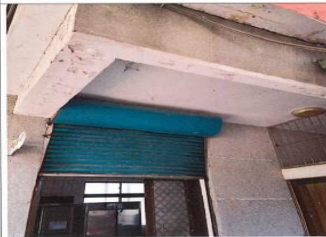
教室東面大門口走廊已老舊斑駁，油漆脫落嚴重有礙觀瞻。
