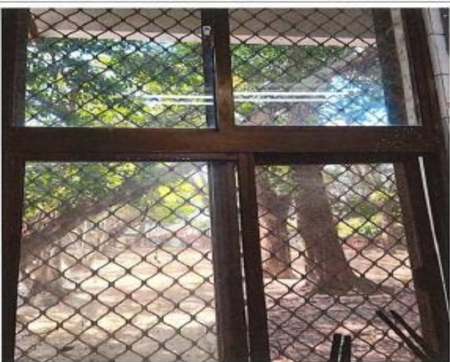
教室窗沿下雨時會滲水且部分門栓亦毀損無法使用，亟需更新。
