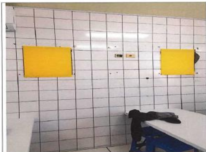
教室舊有抽油煙機孔洞未填平，除不美觀外當雨季來時雨水會滲入教室內。
