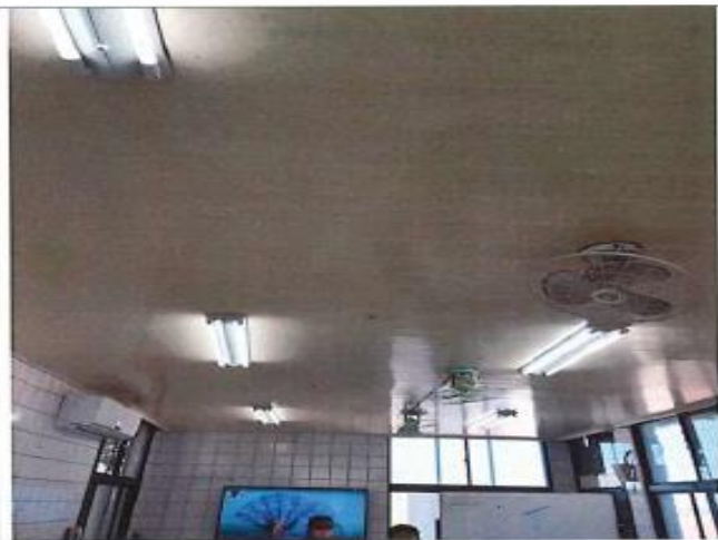
教室天花除老舊外，之前廚房油煙污垢依然殘留在上面。
