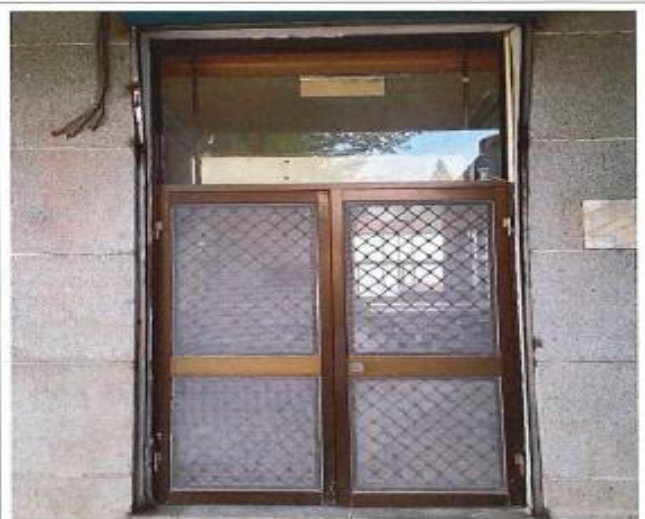
教室鋁製紗門老舊且鏽蝕且門把損壞。
