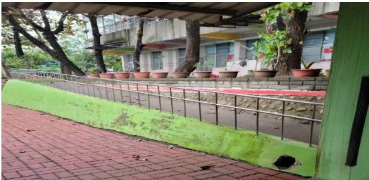
後棟殘障坡道牆面油漆斑駁，預計以陶板畫拼貼設計替換原有漆面
