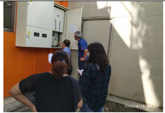
說明：校園電力設備檢查(2)
