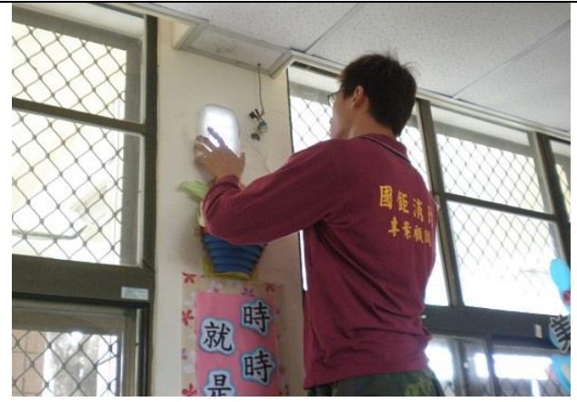
說明：緊急照明燈檢查測試
