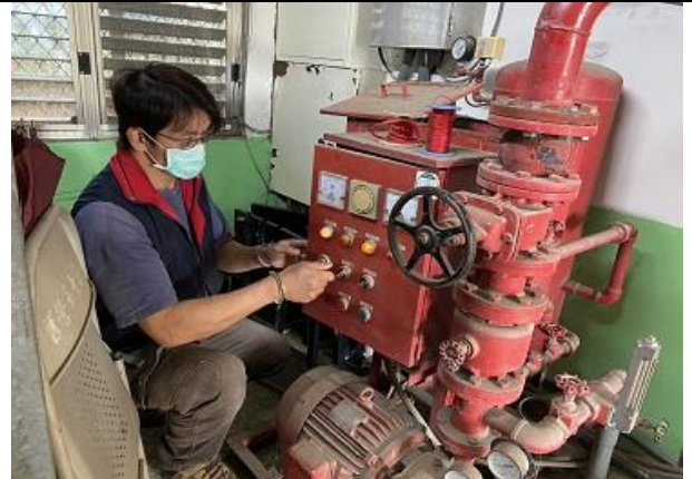
說明：校園電機室總電源檢查
