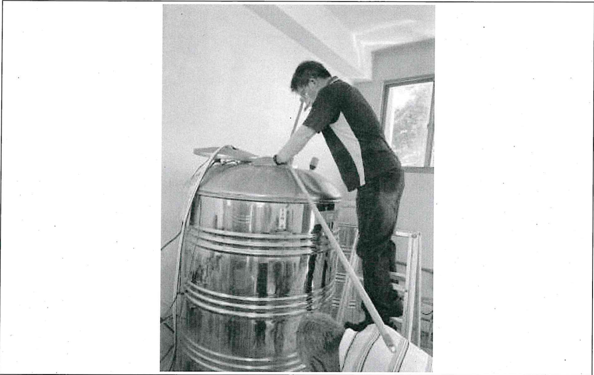
定期巡檢及清洗
