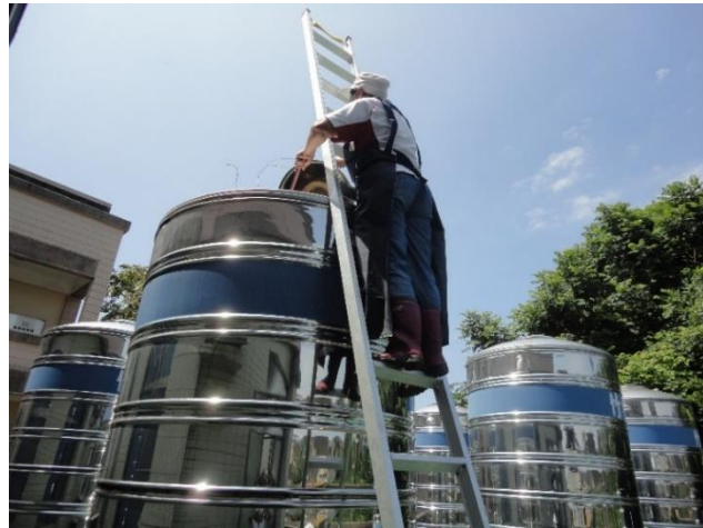
說明：教室飲水器供水設備清潔維護
