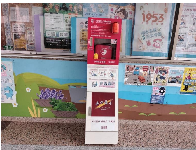
穿堂擺放 AED 緊急救護設備
