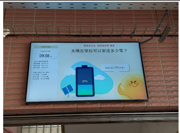
說明：穿堂明顯處設置太陽能發電說明。
