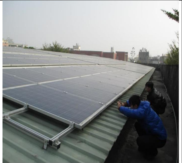
活動中心屋頂鋪設太陽能板裝置，避免陽光直射樓頂，具有隔熱降溫效果，減少風扇、冷氣的使用。
