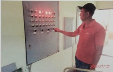
電控檢查中作業
