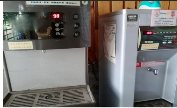
說明:校園提供完善的飲水設備
