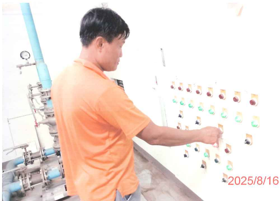
作業後電控檢查
