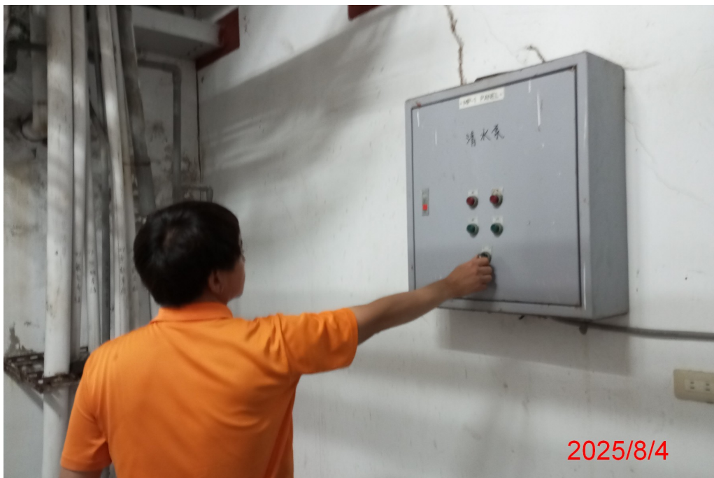
清洗後電控檢查
