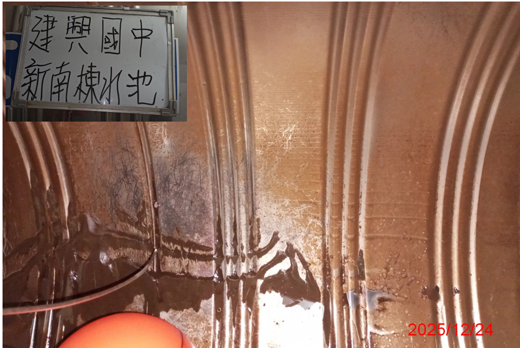
新南棟水池清洗前
