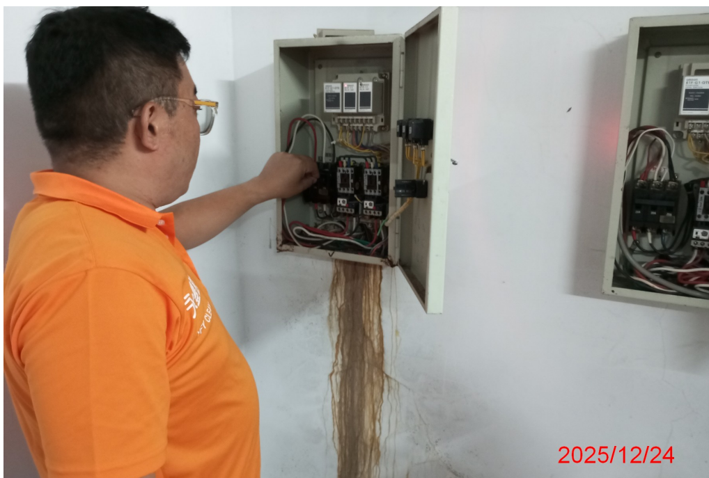
清洗後電控檢查
