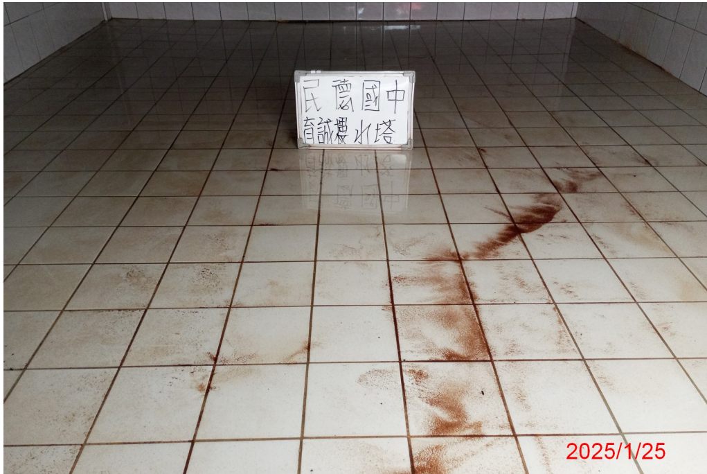
育誠樓水塔清洗前
