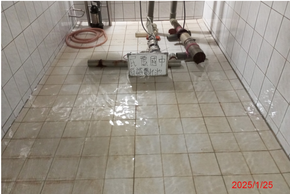
育誠樓水池清洗前
