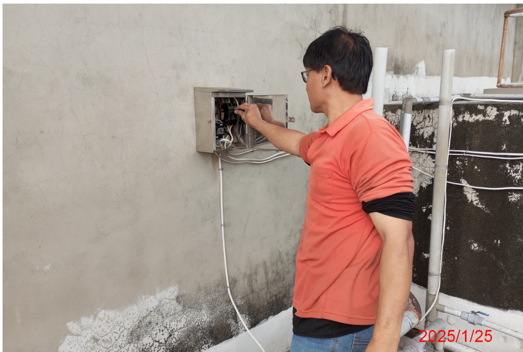
清洗後電控檢查
