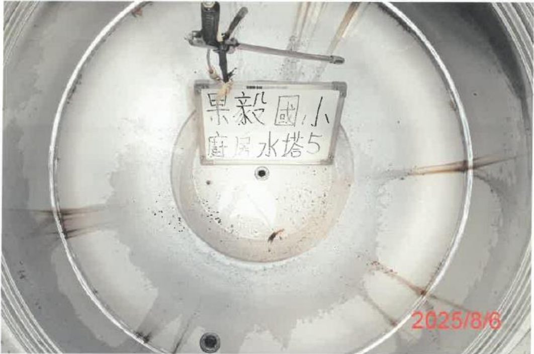
(廚房-5)水塔清洗前
