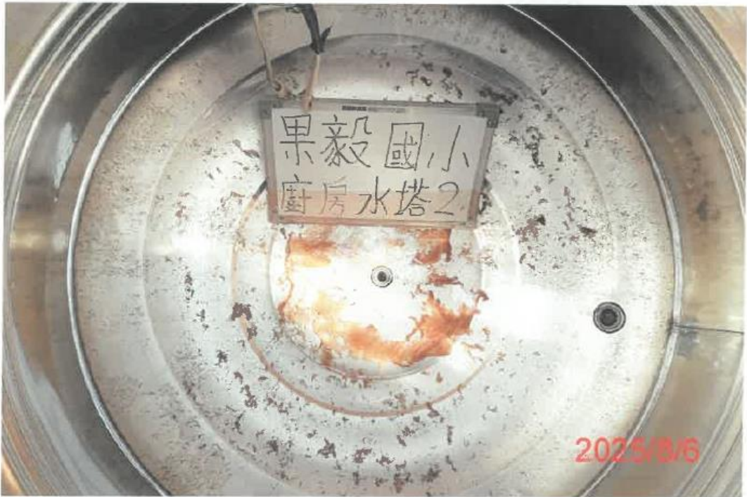
(廚房-2)水塔清洗前
