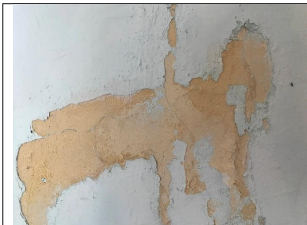
教室牆壁出現壁癌粉塵，影響健康
