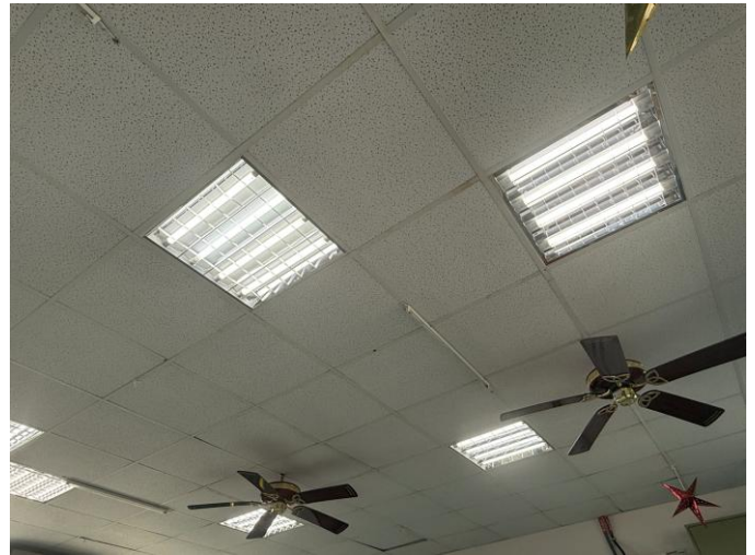
說明：教室全面使用 LED 燈管，節省能源
