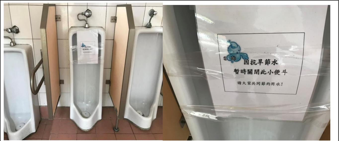
抗旱節水下關閉部份小便斗，以節約用水
