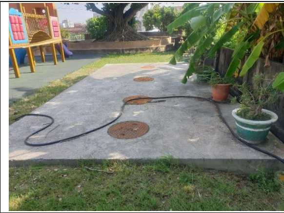
說明:設置雨水回收系統，改善排水並利用雨水澆花灌溉
