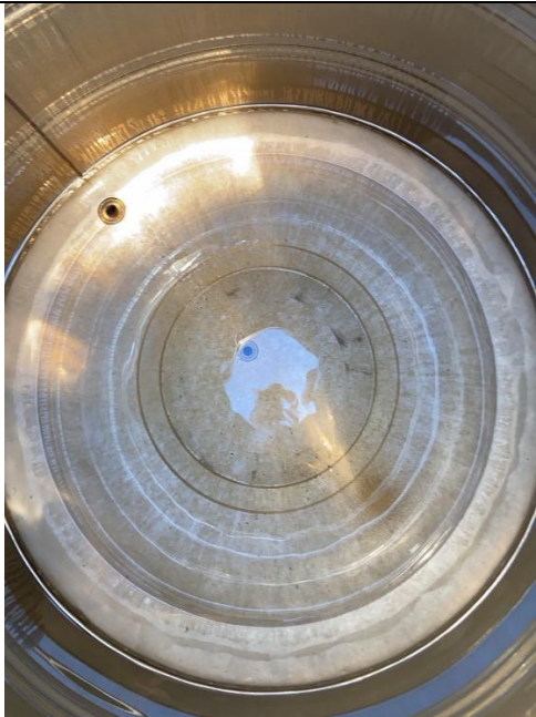
廚房上方水塔(5)清洗前
