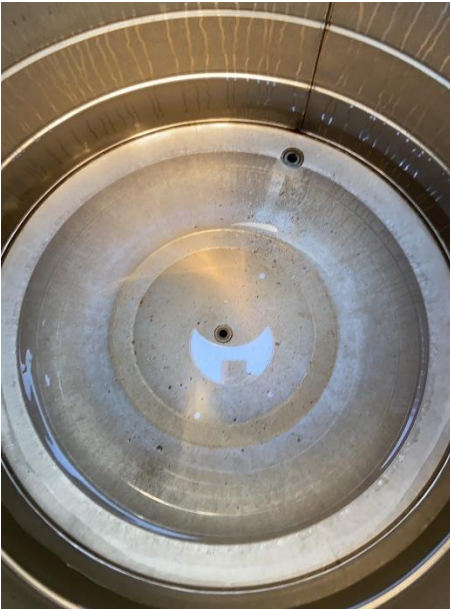
廚房上方水塔(2)清洗前
