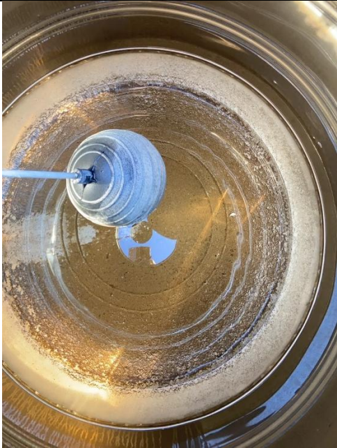
廚房上方水塔(4)清洗前
