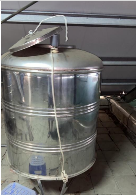
教學大樓頂樓水塔(1)外觀清洗前
