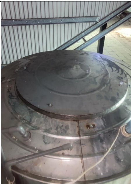
教學大樓頂樓水塔(4)外觀清洗前
