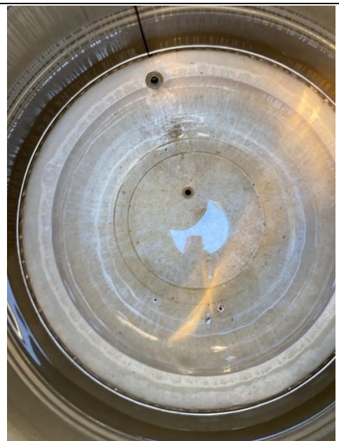
廚房上方水塔(6)清洗前
