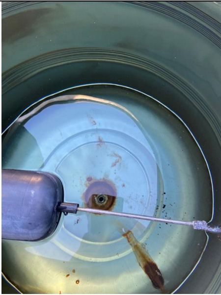
廚房上方水塔(1)清洗前
