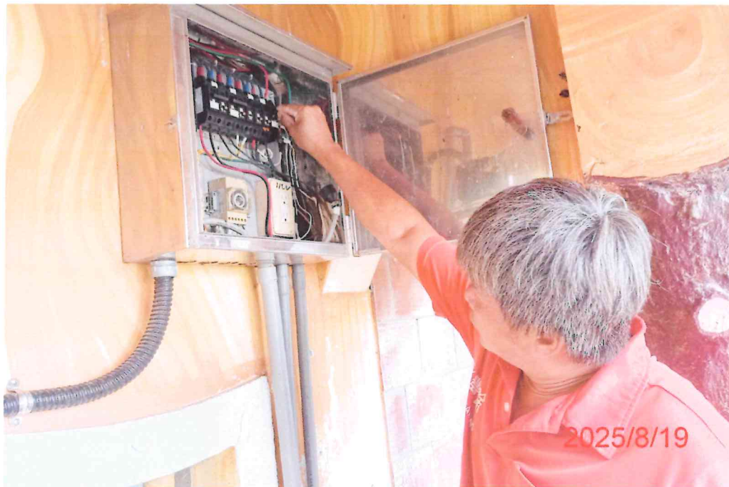
作業後電控檢查
