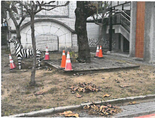
木製平台限制樹木生長，並因土石流失造成高度落差，容易踩空受傷。
