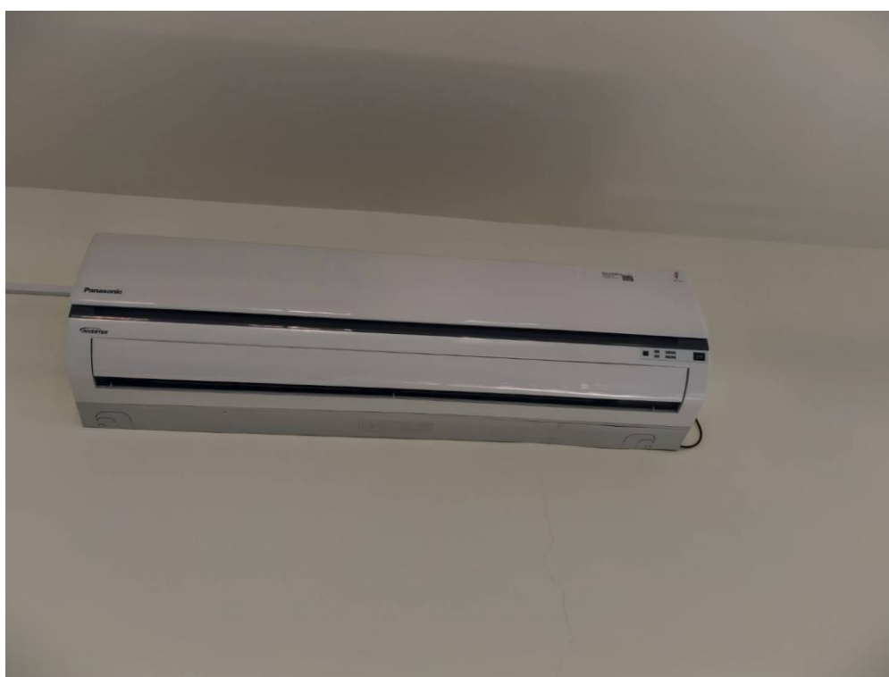
說明：節能設施-使用一級節能冷氣
