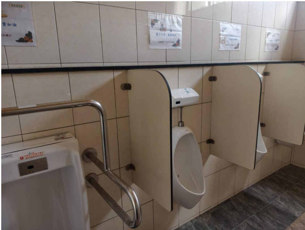
說明：節能設施-節水感應式小便斗馬桶設置
