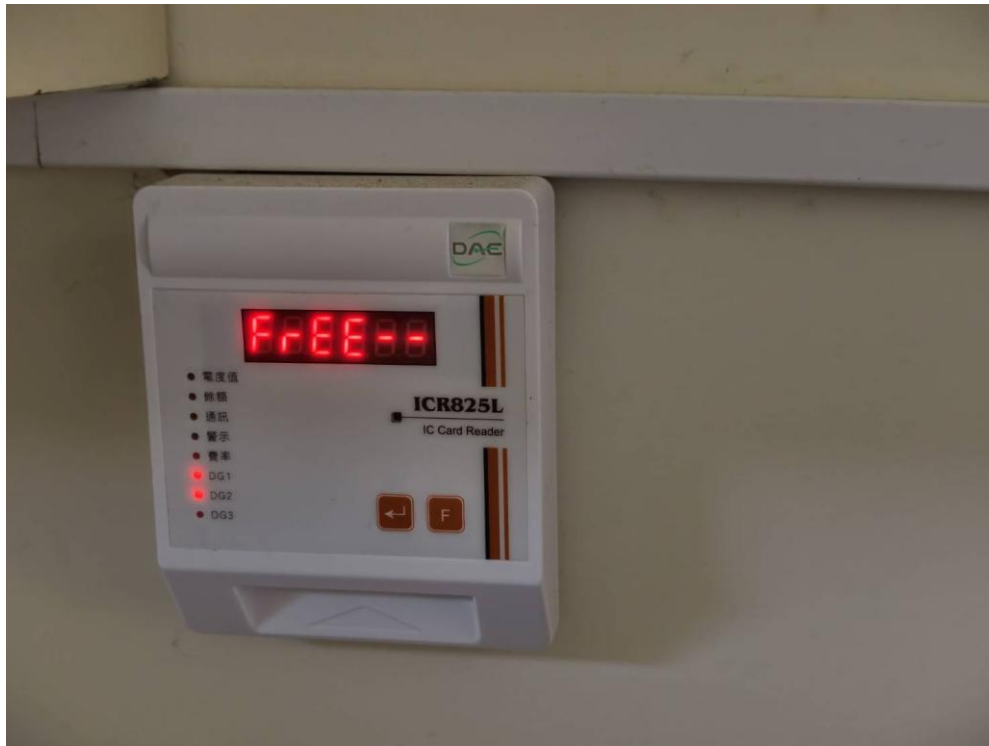
說明：節能設施-EMS 智慧能源管理系統設置
