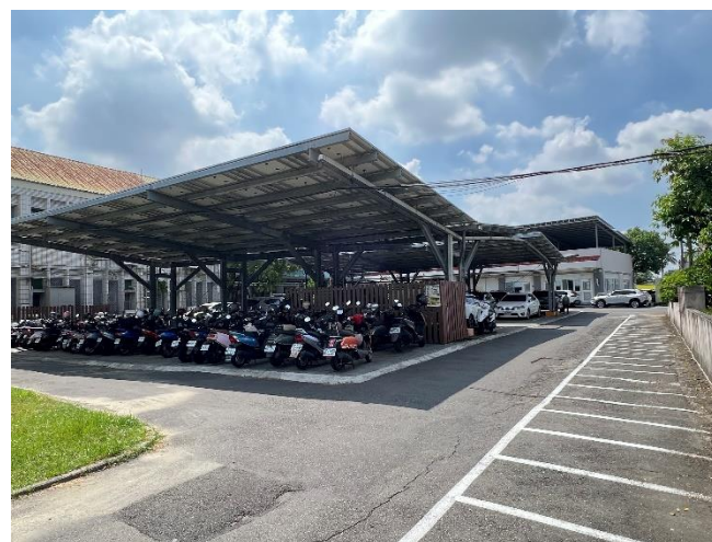
太陽光電停車場
