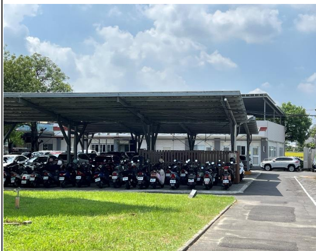
太陽光電停車場
