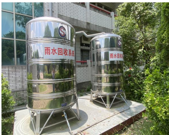
說明：雨水回收再利用水塔
