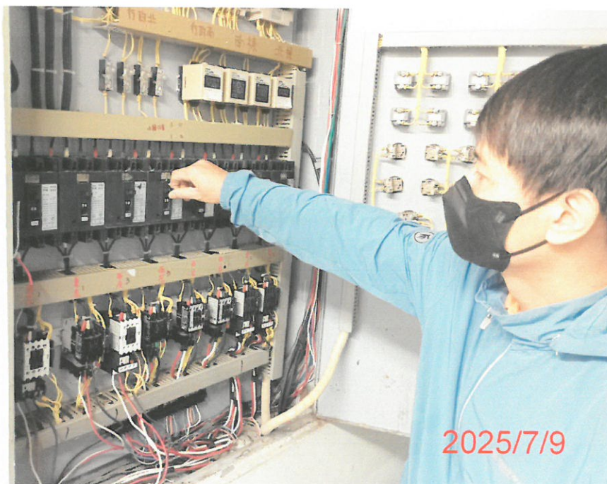
作業後電控檢查
