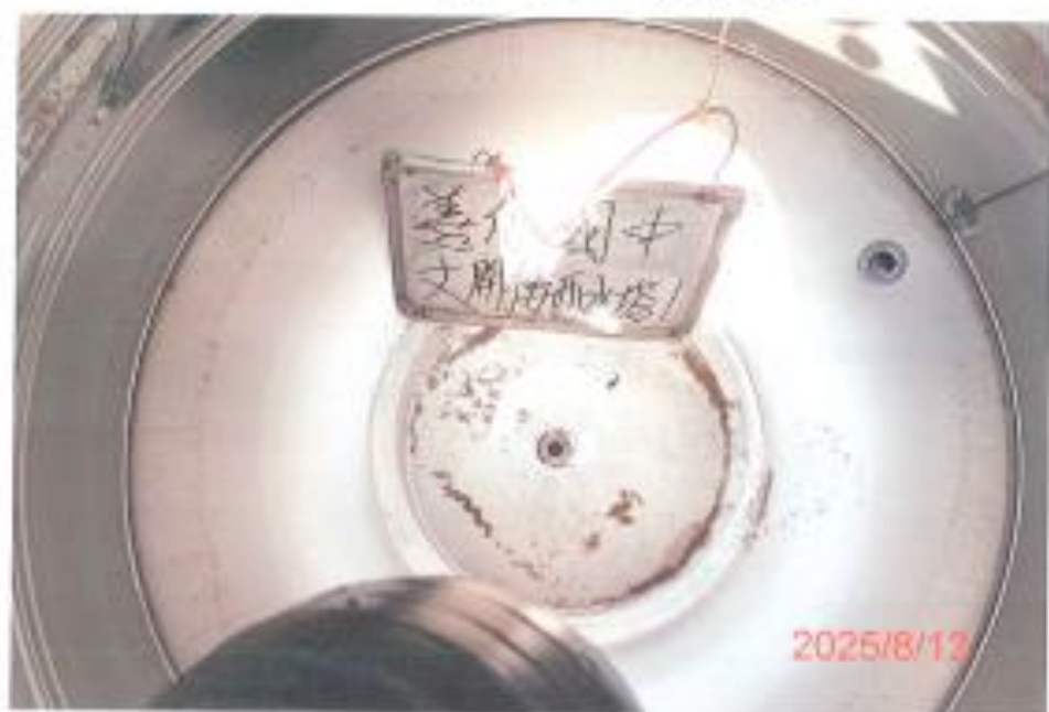
(文開樓西-1)水塔清洗前
