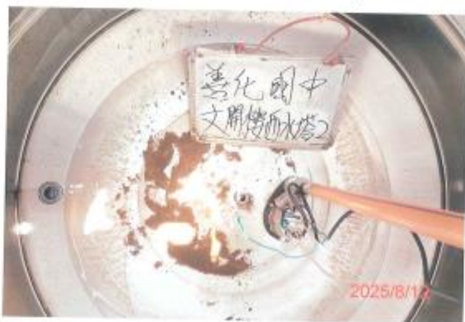
(文開樓西-2)水塔清洗前
