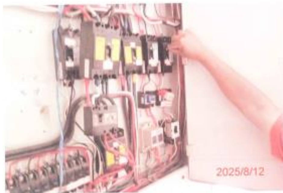
作業後電控檢查
