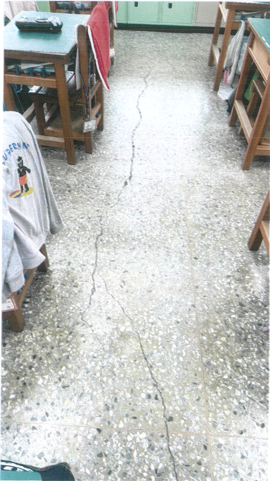
南棟 S102 教室地板有裂縫(114 年 2 月 4 日)
