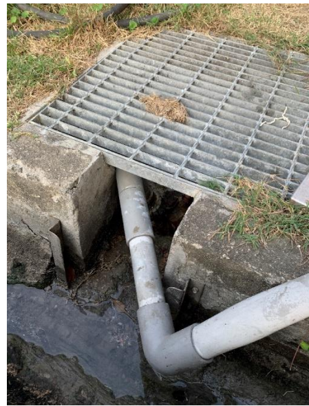
水溝內安裝抽水馬達將水抽出灌溉
