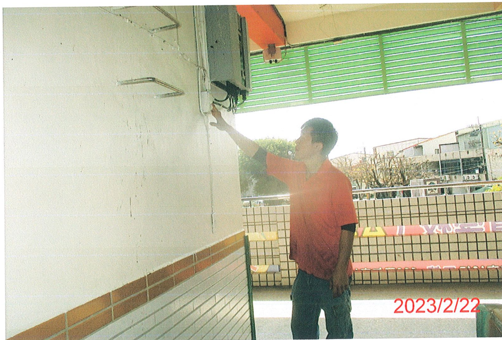
電控檢查中作業
