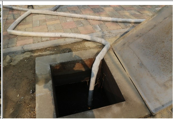
水資源回收水送入地下水撲滿中
