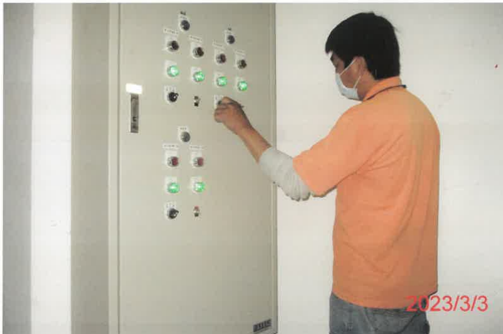
電控檢查中作業
