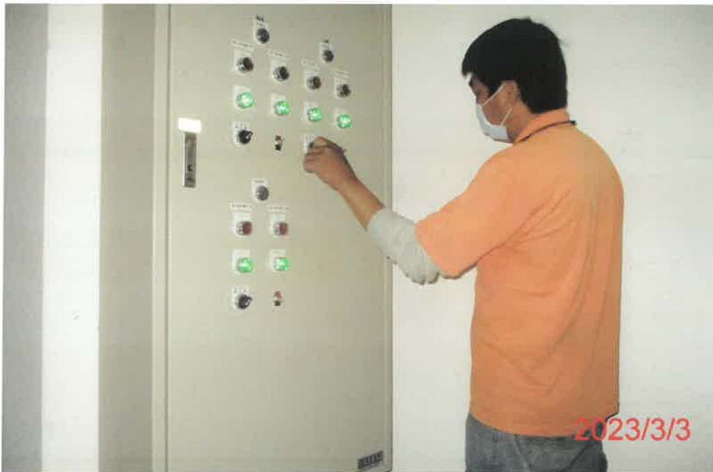
電控檢查中作業
